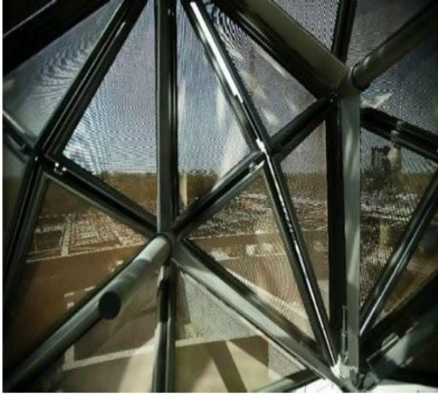
الألياف الزجاجية المستخدمة في الواجهة الخارجية للمبنى المصدر: (Voitstudios, 2017)
